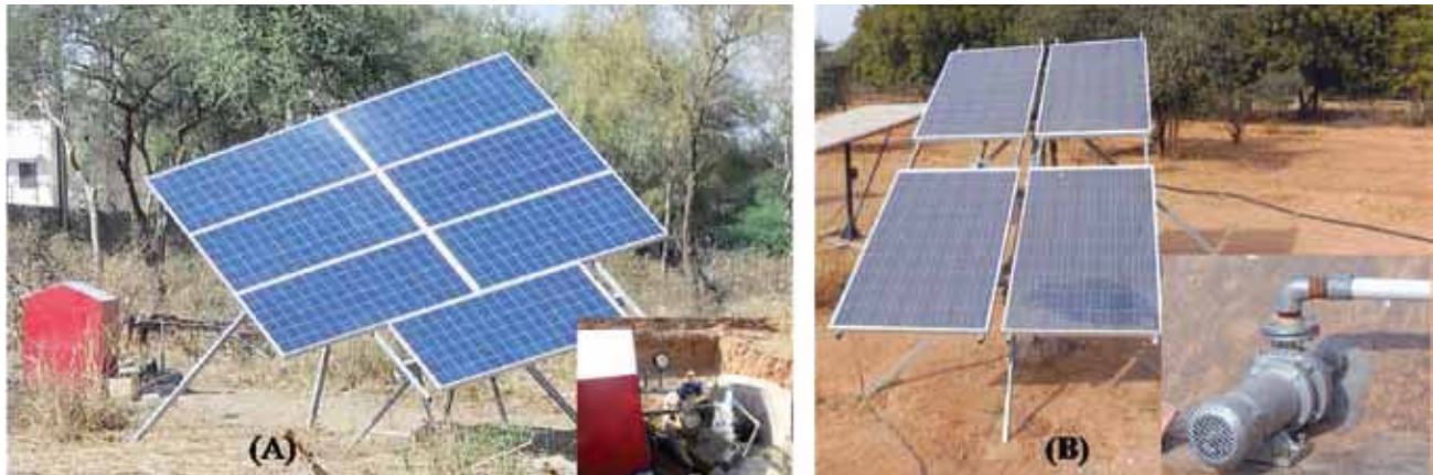
चित्र 8.8 सौर फोटोवोल्टाइक पम्प (अ) 1400 वाट एसी पम्प के साथ (ब) 900 वाट डीसी पम्प के साथ Fig. 8.8 Solar photovoltaic pumps with 1400 Wp AC pump (A) and with 900 Wp DC pump (B)
