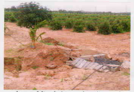
टूटे हुए सीमेंट के निकास से भारी मात्रा में मिट्टी का कटाव
