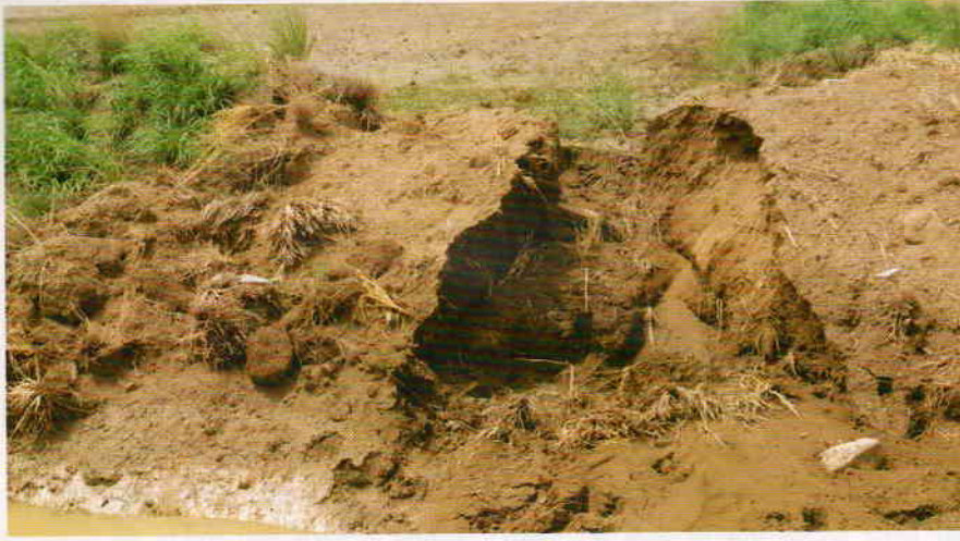
मिट्टी से बनी मेड़ के टूटने का खतरा
