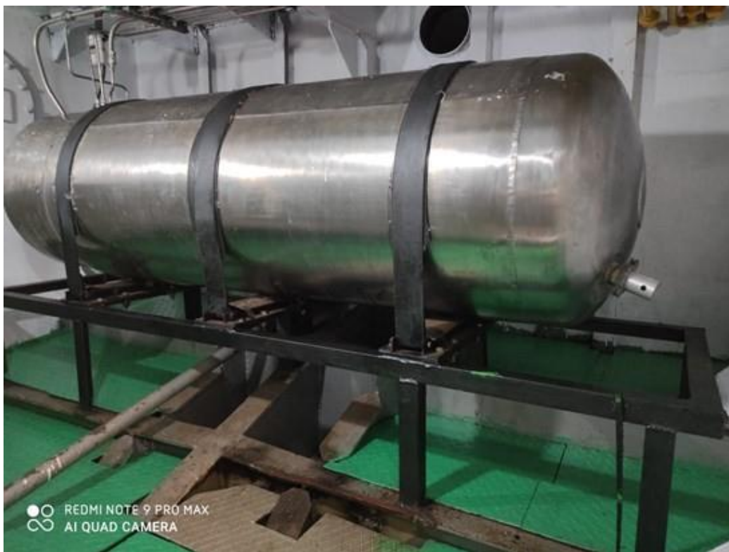
Fig. 14. LNG tank inside fishing vessel
