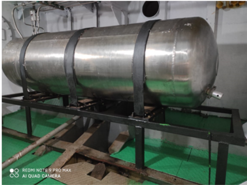
LNG tank inside fishing vessel
